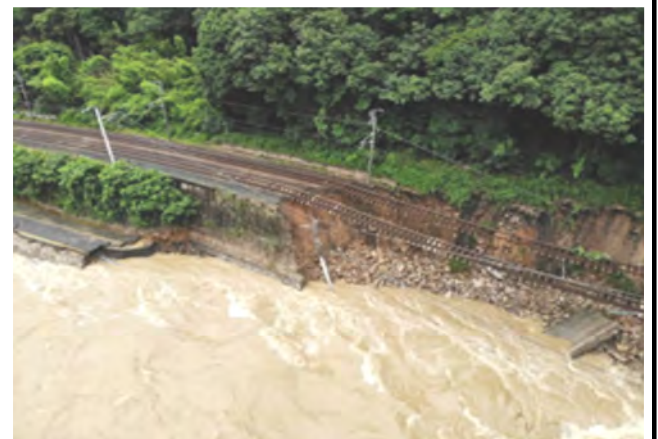
山陽本線・本郷～河内間土砂流出
